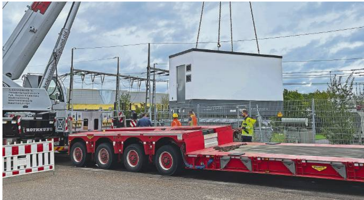
30 Tonnen hängen am Kran: Innerhalb von nicht einmal 15 Minuten wird der Knotenpunkt – das Herzstück der Breitbandversorgung befindet sich in dem Häuschen – auf dem Grundstück der Stadtwerke Mühlacker platziert.
