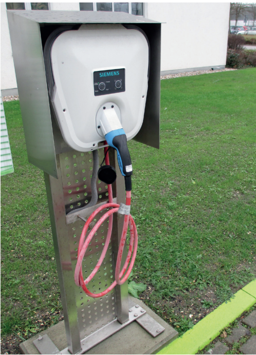
Bild 12: Ladestation im Außenbereich mit Regendach
