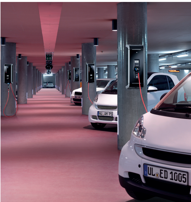
Bild 9: Ladeeinrichtungen für Elektrofahrzeuge in einer Tiefgarage
