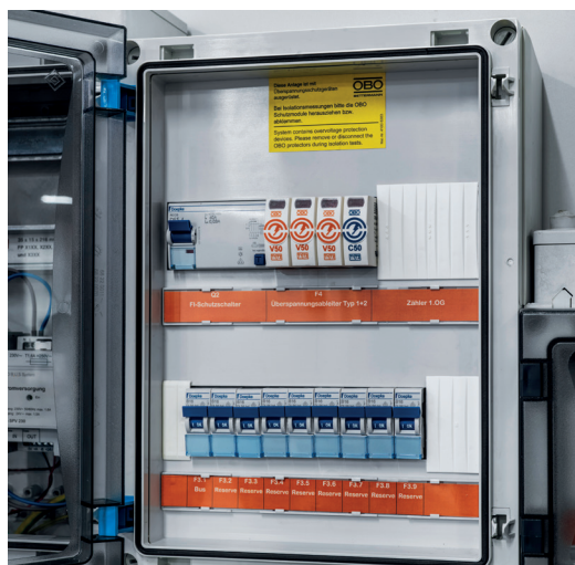
Bild 11: Im Verteiler eingebaute Überspannungsschutzeinrichtung Typ 2
